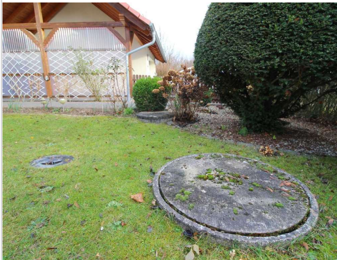
Zisterne, Filter- und Abwasser
